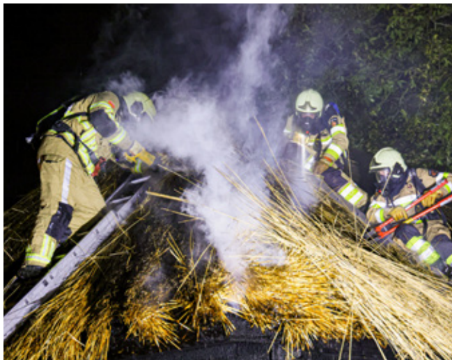
Bijgebouw met rieten dak in brand in Bruchterveld.
