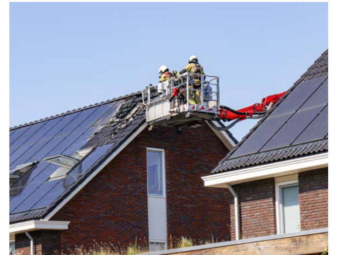
Brand in zonnepanelen Zwolle
