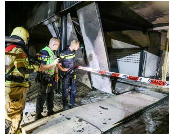
Brandstichting in bedrijfspand Marslanden Zwolle
